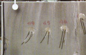
Tubi in gomma che fuoriescono dalla parete dove è collocato il VTR.
